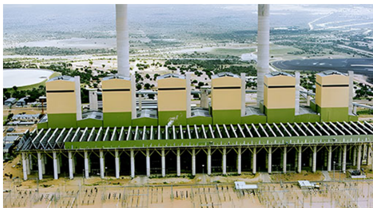
Figura 2.39 Aerocondensadores de la central térmica de carbón, Matimba Power Station (Sudáfrica) [36].
