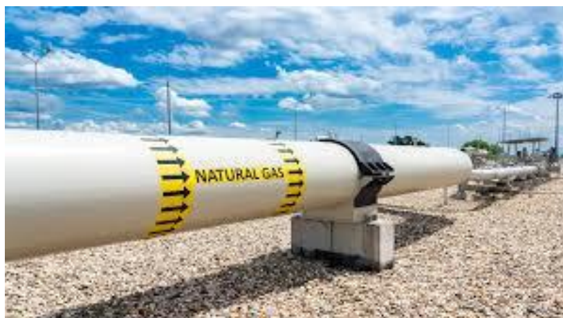
Figura 15: Gasoducto de Gas Natural. [22]
